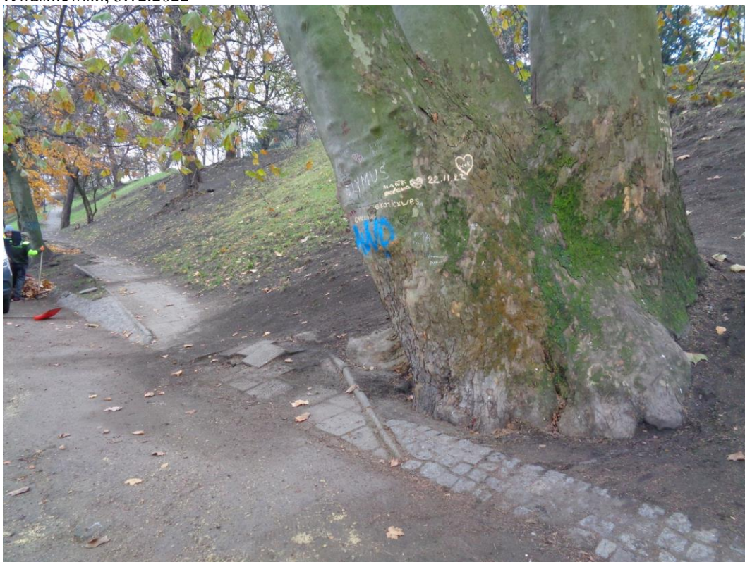
Ryc. 244. Wrocław, Wzgórze Partyzantów, widok od strony północnej na zbieg ścieżki zboczowej wschodniej (z uszkodzoną nawierzchnią) i ścieżki nadbrzeżnej wschodniej oraz pomnikowy platan. Fot. A. Kwaśniewski, 5.12.2022
