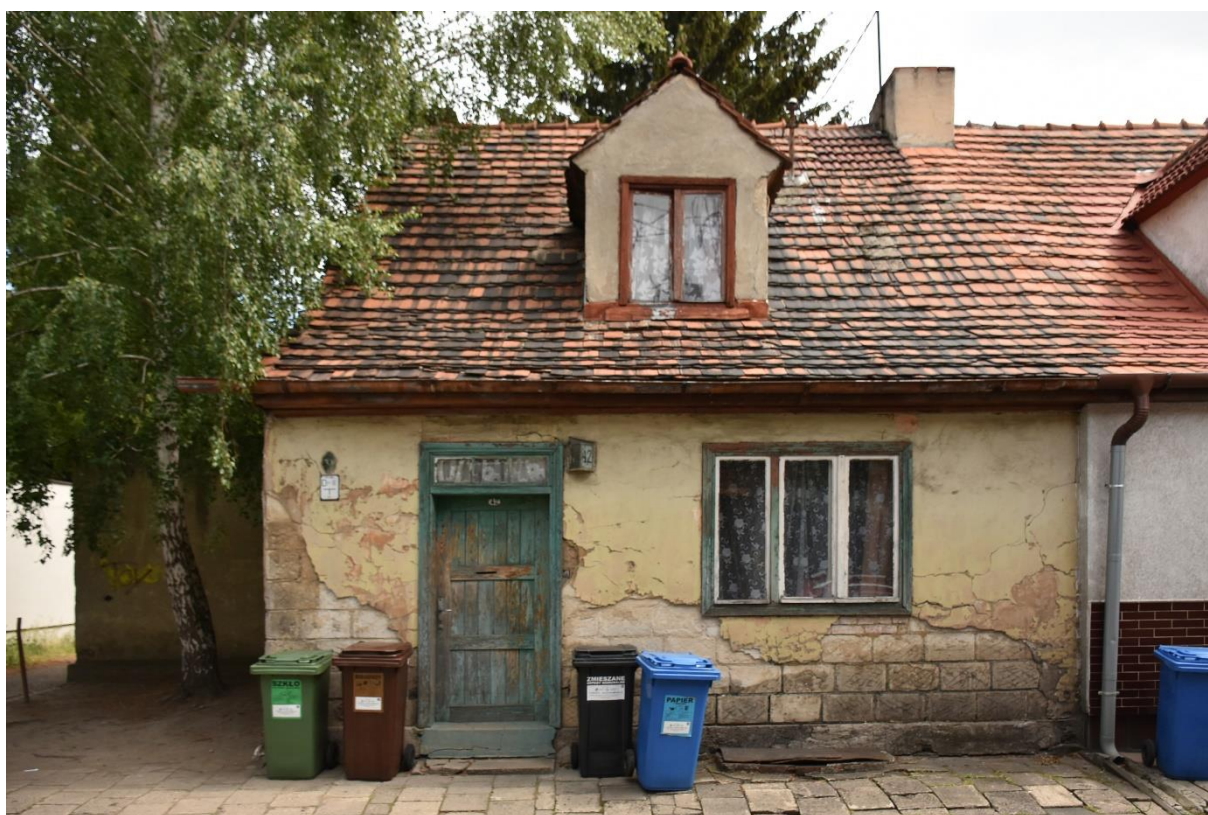
Fot. 8 Ulica Kamieniecka 42. Dom z widocznymi dzięki ubytkom tynku blockami betonowymi, widok od zachodu.
