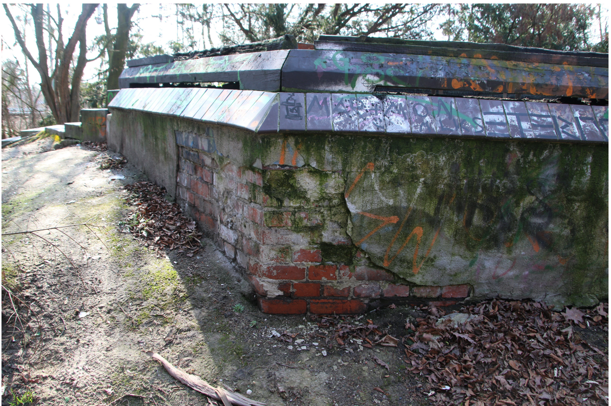
fot.2 – Ubytki tynku na stronie północnej.
