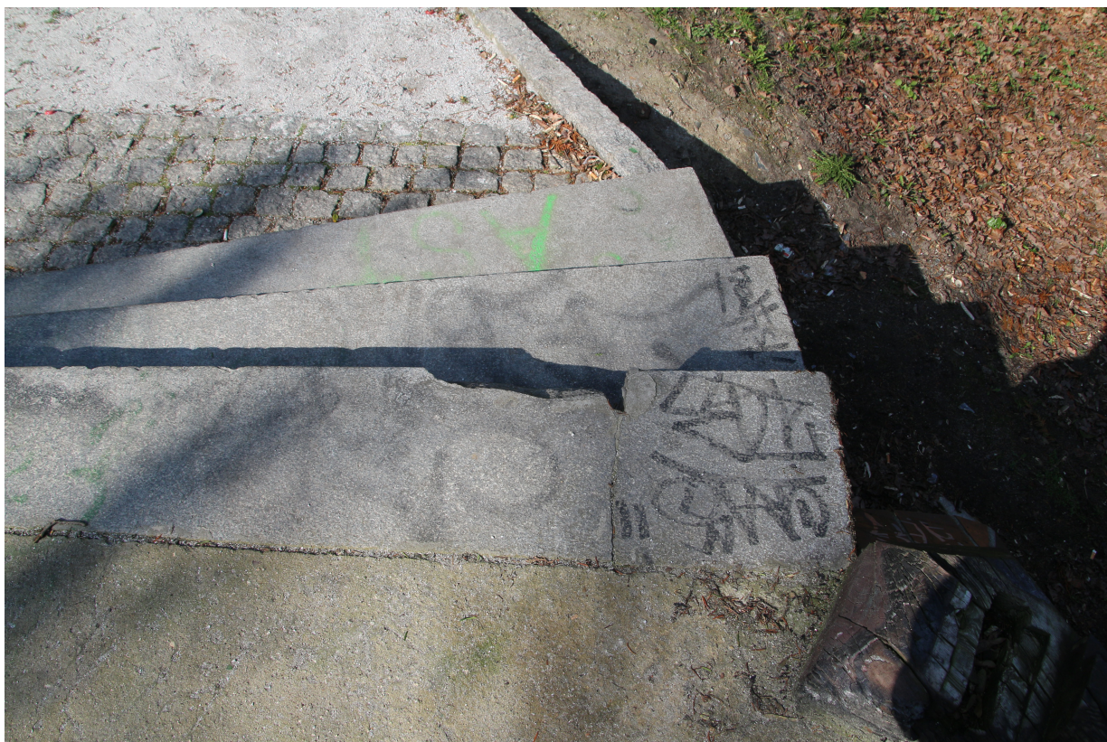
fot.3 – Mechaniczne uszkodzenie stopnia (strona zachodnia).
