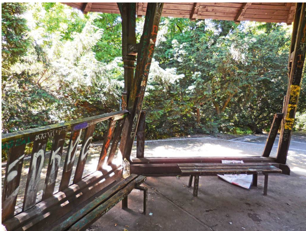
Zdjęcie Nr 6 Uszkodzenia balustrady i ławek.
