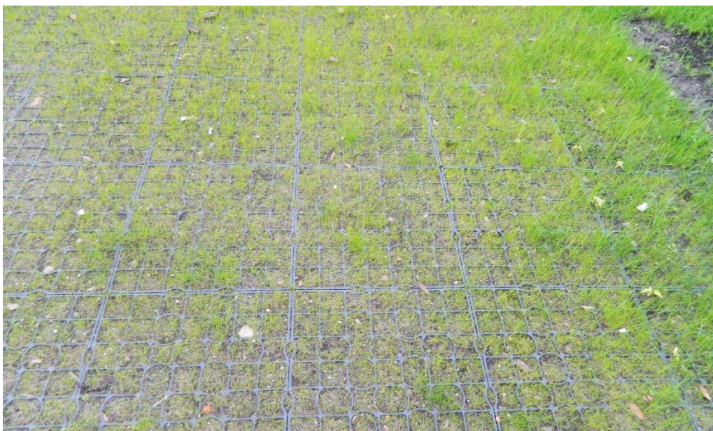
Zastosowanie geokompozytu komórkowego, zdjęcie wykonane wczesną wiosną, Warszawa (fot. E. Burszta-Adamiak)
